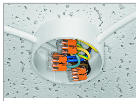
Distribution d'éclairage dans les plafonniers
